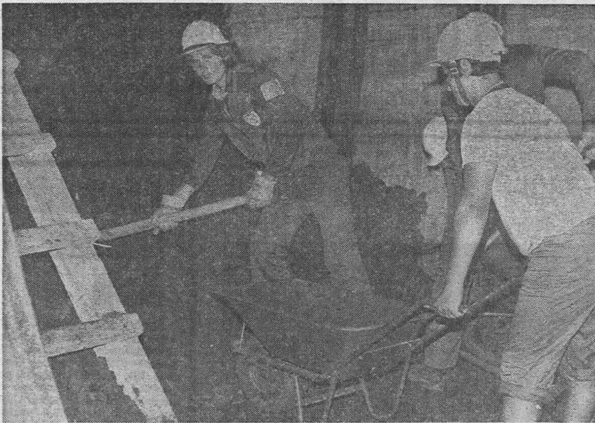
Specijalna brigada je napala Bistričak kroz koji treba da bude probijen tunnel do 15. novembra
